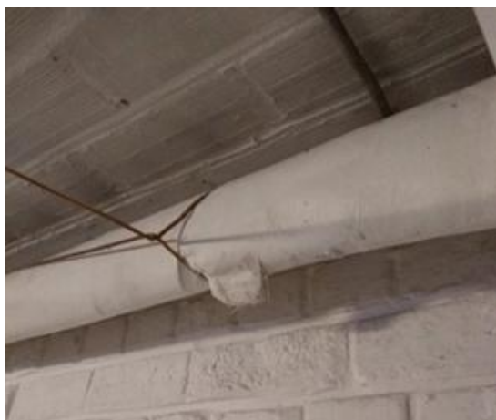
gipspleister rond isolatie verwarmingsbuizen
